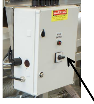
Фото 22. Коробка питания оборудования с главным выключателем
